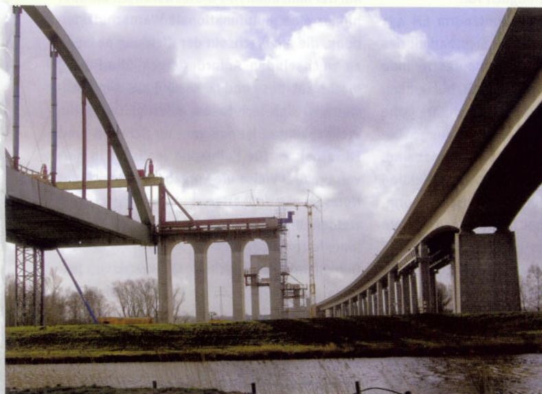
Die Brücke wurde seitlich neben den Pfeilern auf Höhe gehoben und dann auf die Pfeiler geschoben. | Fotos: Aldick / bi-BauMagazin
